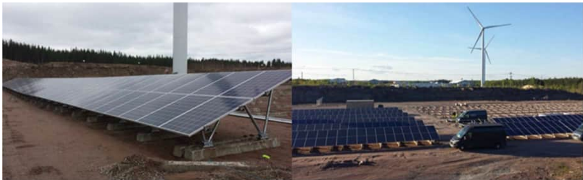
Kuva 90. Esimerkki aurinkopaneeleista (Suomen Voima Oy, Mäkelänkankaan aurinkovoimalat, Hamina).
