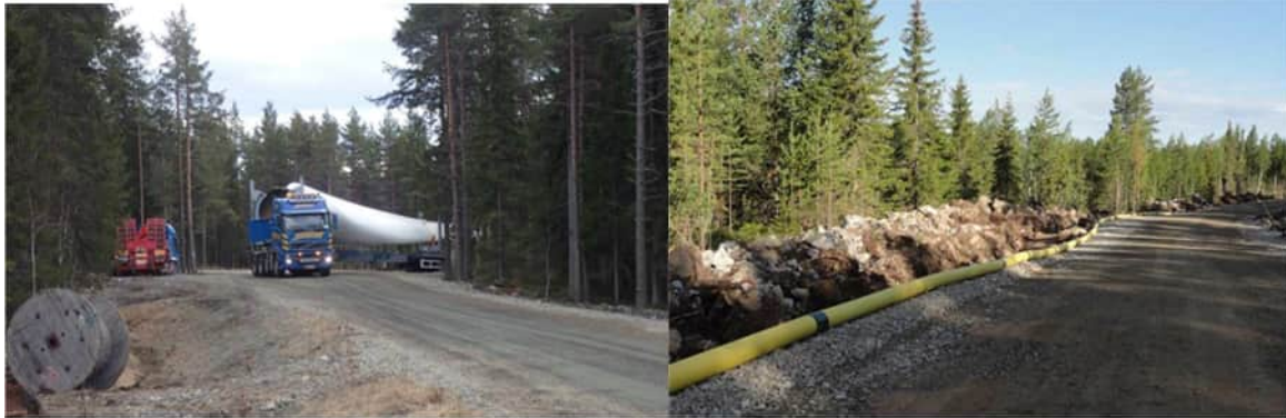
Kuva 91. Kuvapari. Vasemmalla: Esimerkki tuulivoimapuiston rakennus- ja huoltotiestä. Maakaapeli sijoitetaan ojakaivantoon tien reuna-alueelle. Oikealla: Tuulivoimalan osia kuljetetaan erikoiskuljetuksina. (Kuvat: FCG).
