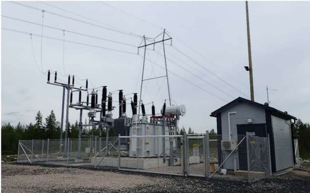
Kuva 88. Esimerkki tuulivoimapuiston sähköasemasta (Kuva: FCG).
